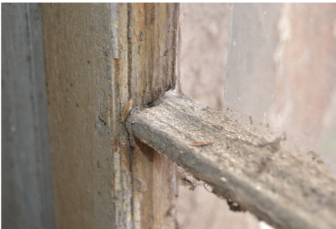
Il. 16 Dusocin – Budynek mieszkalny w zabytkowej zagrodzie wiejskiej – stolarka okienna - parter – widok na profilowanie ramiaka oraz szczeliny pierwotnej stolarki okiennej
