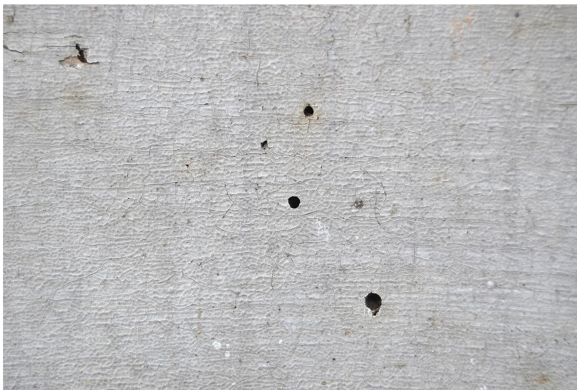
Il. 58 Dusocin – Budynek mieszkalny w zabytkowej zagrodzie wiejskiej – stolarka okienna - okiennice – widok na otwory wlotowe i wylotowe kołatka żerującego w okiennicach
