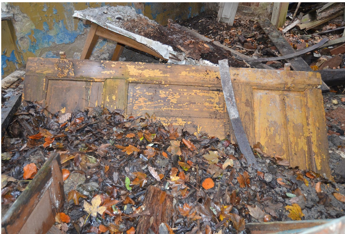
Il. 129 Dusocin – Budynek mieszkalny w zabytkowej zagrodzie wiejskiej – stolarka drzwiowa - drzwi wewnętrzne TYP III – widok na pierwotne skrzydło drzwiowe leżące w gruzach fot. Ewa Bożejewicz 2018 r.
