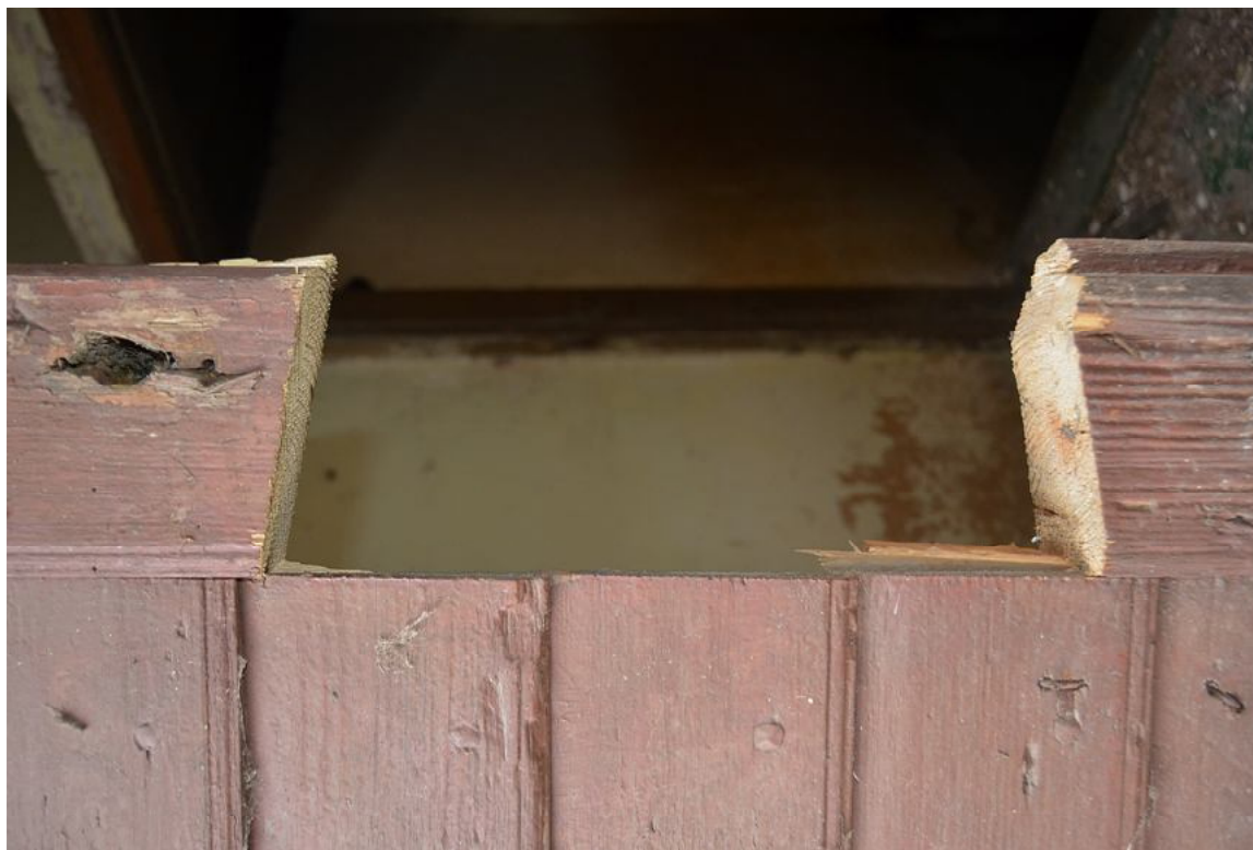
Il. 94 Dusocin – Budynek mieszkalny w zabytkowej zagrodzie wiejskiej – stolarka drzwiowa - drzwi wejściowe boczne – widok na miejsce po wyciętym zamku i klamce, zrabowanym podczas opracowywania dokumentacji
