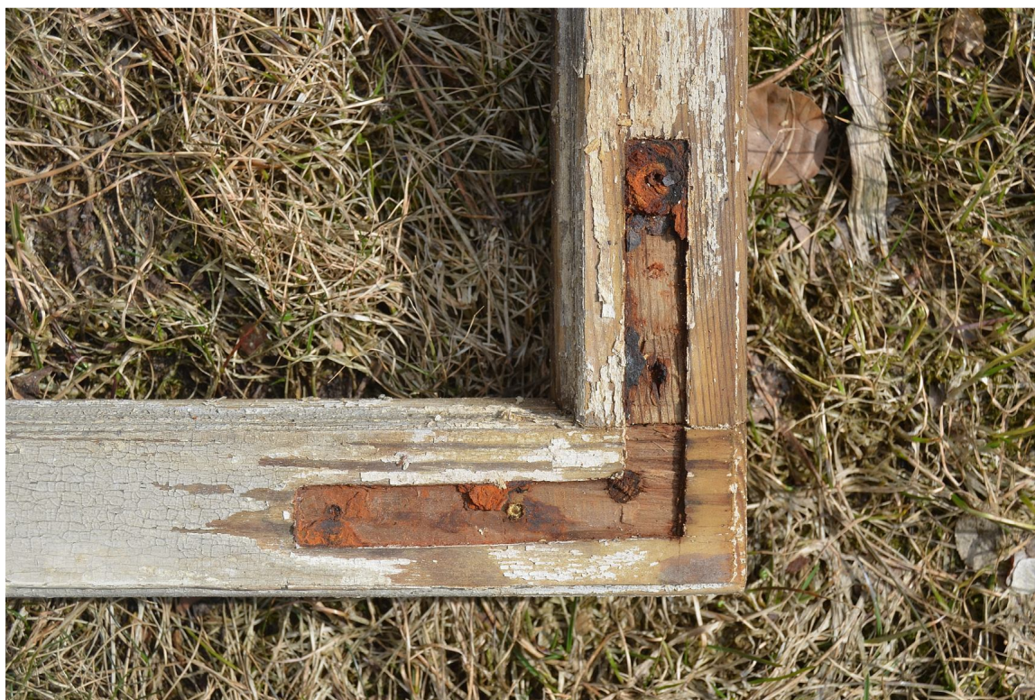
Il. 22 Dusocin – Budynek mieszkalny w zabytkowej zagrodzie wiejskiej – stolarka okienna - widok na fragment skrzydła ze zdemontowanym narożnikiem okiennym
