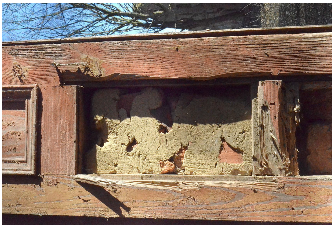
Il. 82 Dusocin – Budynek mieszkalny w zabytkowej zagrodzie wiejskiej – stolarka drzwiowa - drzwi wejściowe główne (D/1) – widok na zniszczenia ościeżnicy ramowo-płycinowej fot. Ewa Bożejewicz 2018 r.
