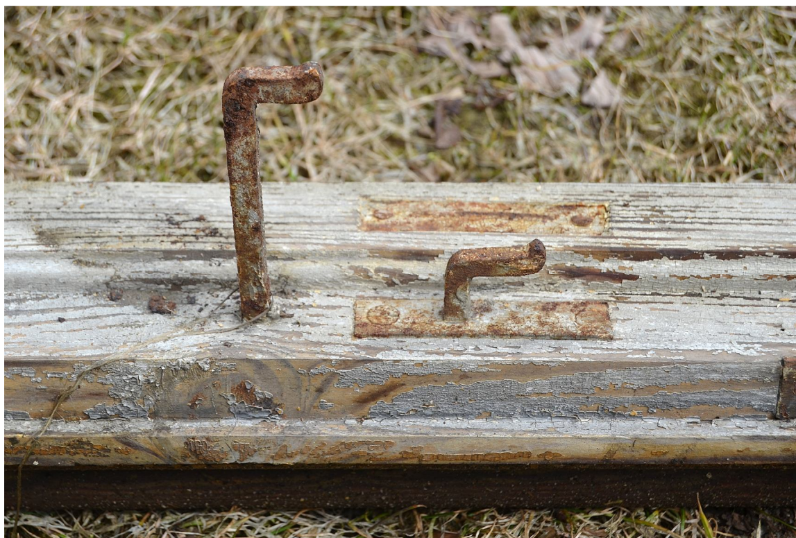
Il. 52 Dusocin – Budynek mieszkalny w zabytkowej zagrodzie wiejskiej – stolarka okienna - okiennice – widok na fragment stolarki okiennej z hakiem zakrętki dźwigniowej okiennicy
